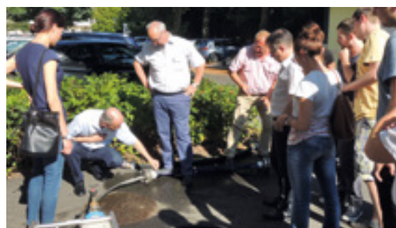
Warum ist diese Schlauchleitung frühzeitig geplatzt? Die Teilnehmer suchen zusammen mit Peter Badners nach der Ursache
